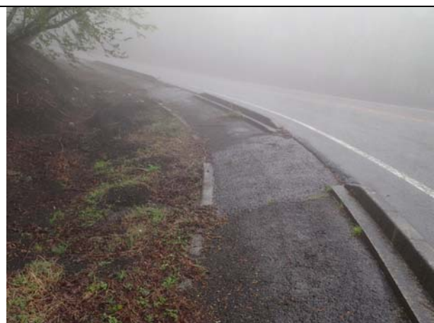
ふじあざみライン上り線区画 No. 60 (令和元年 5 月 22 日撮影)
