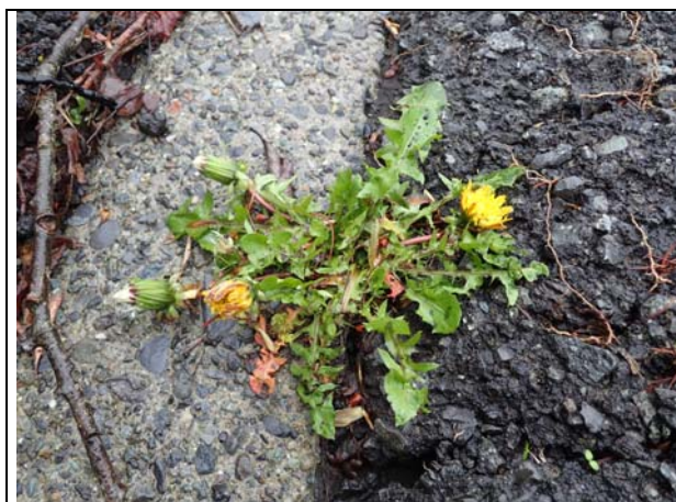
ふじあざみライン上り線区画 No. 58 (令和元年 5 月 22 日撮影)
