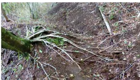
(2013/6/22 反対方向から、根周り空洞化と亀裂)
