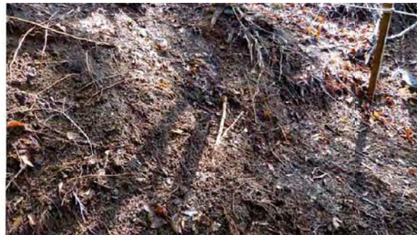
(2014/4/23 一年後、斜面の削れ、侵食が進む)
