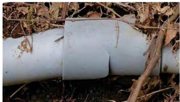
(2014/4/26 配水管のヒヒが広がり水漏れしている)
