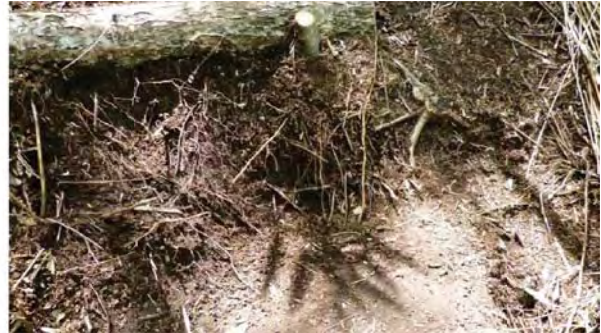
(2014/5/24 雨後 階段前面の削れと脇の斜面の侵食)
