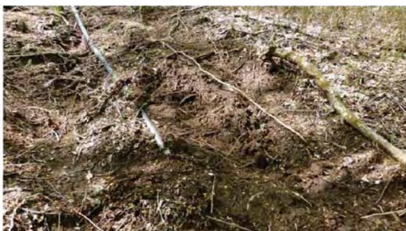
(2014/5/24 雨後、ホース両側で侵食が進む)
