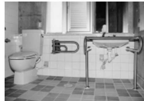
新設の須走口チップ(協力金)制トイレ内部
